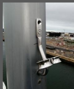
La ferrure de l'étai sur le mât (le point manquant a été complété... !)
